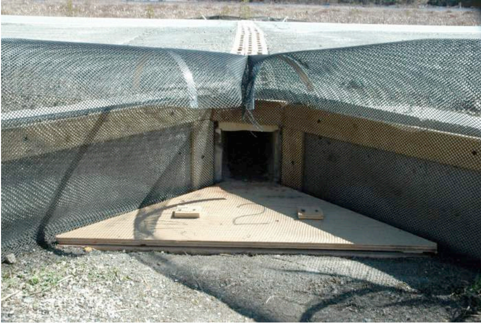
Figure 3. Entrée du tunnel permettant aux amphibiens de traverser la route 220 sans danger.
