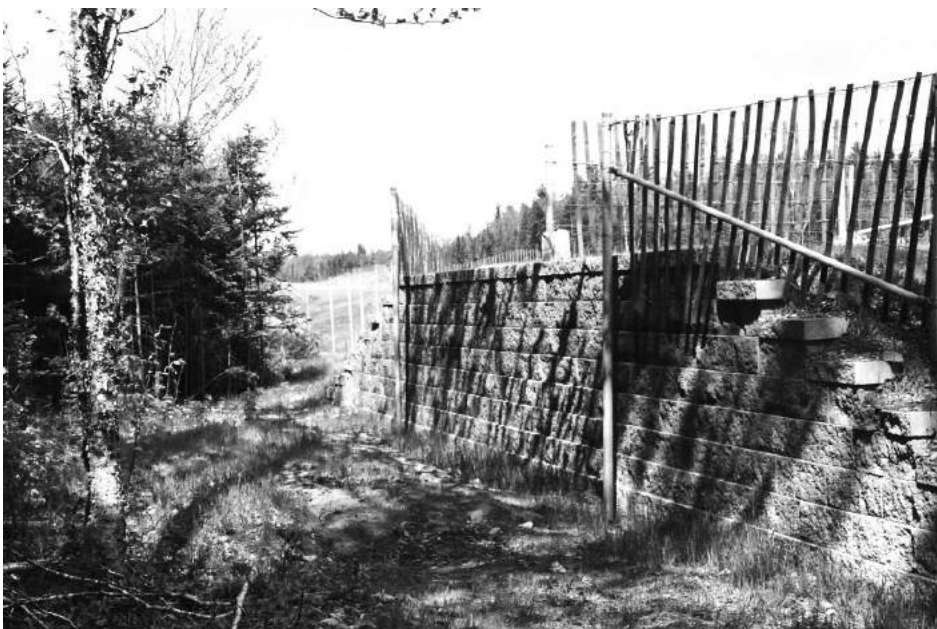
Figure 2. Un des 30 sautoirs installés dans le ravage de cerfs de Virginie de Calway dans le secteur du prolongement de l'autoroute Robert-Cliche (73), Saint-Joseph-de-Beauce, Québec. En haut: Vue de la pente douce du côté de l'autoroute. Ci-dessous: Vue du mur vertical du côté de la forêt.
