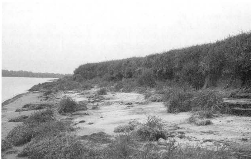
Île des Barques Talus érodé en pente douce avec plaque de sol détachée
