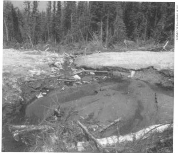
L'érosion est susceptible d'affecter la qualité du milieu aquatique, tout en entraînant une détérioration des infrastructures routières
