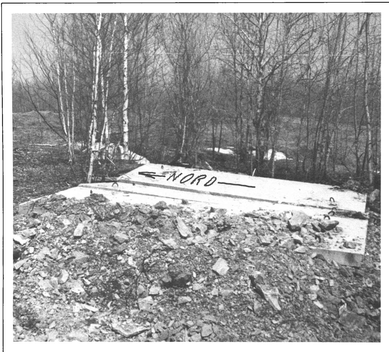
Figure 16 Ouverture dangereuse scellée
