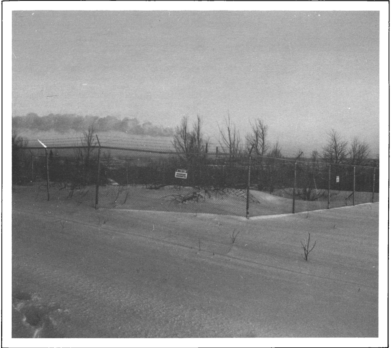
Figure 17 Clôture interdisant l'accès à une ouverture dangereuse
