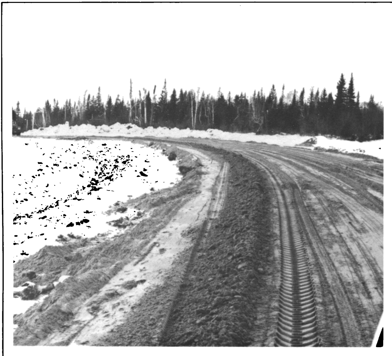
Figure 11 Route à caractère permanent pour la mine El Coco en Abitibi (en construction).
