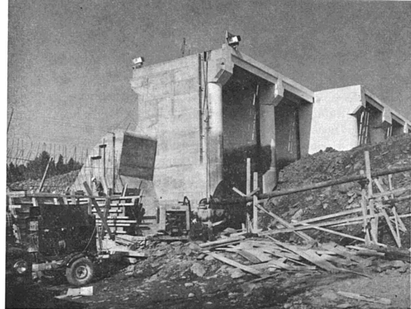
PLANCHE I — Vue amont montrant les détails du déversoir, tels que profil, clés d'alignement, acier d'armature ainsi que l'élévation des piliers.
