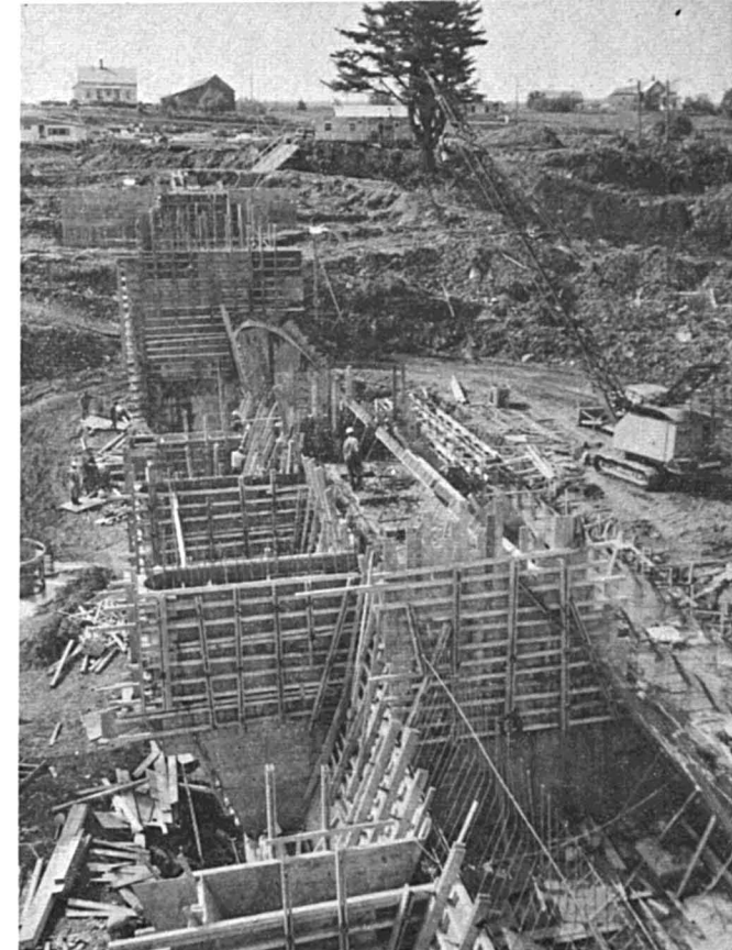
PLANCHE III — Vue générale vers l'ouest montrant l'érection des coffrages selon la méthode des levés successifs.
