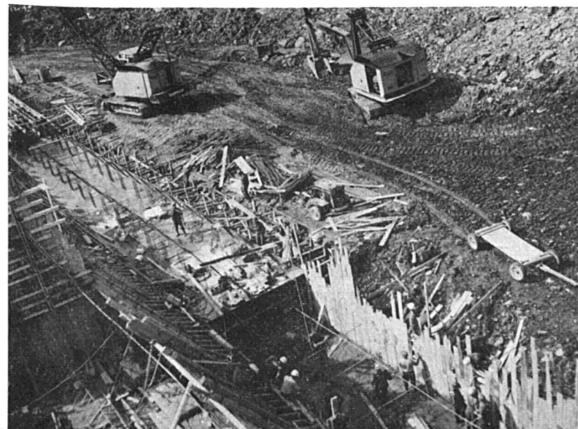
PLANCHE IV — Détail des dalles du radier aval et des dissipateurs d'énergie à trois différents stades de construction.
