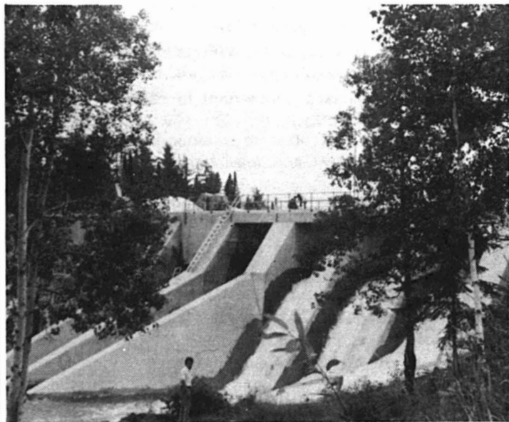
Réfection de la face amont du barrage Pibrac Ouest, sur la rivière au Sable, à Jonquière.
