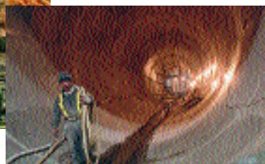
Vue d'une conduite forcée.
