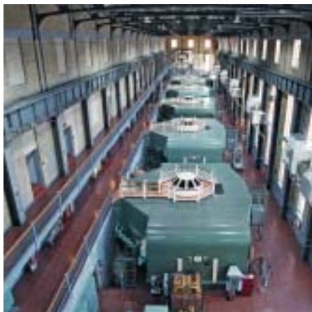
Centrale de La Tuque (Mauricie). Des travaux de rééquipement s'y déroulent, qui en augmenteront la puissance.
