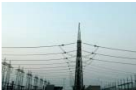
Poste de Boucherville, de la boucle de Montréal. Des travaux y ont été menés pour augmenter la capacité de transit du réseau.
