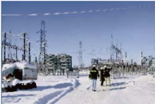
Au poste de Lévis, un déglaceur de lignes à haute tension sera installé.
