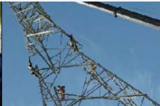
Une ligne à 315 kV relie la centrale de la Toulnostouc et le poste de Micoua.
