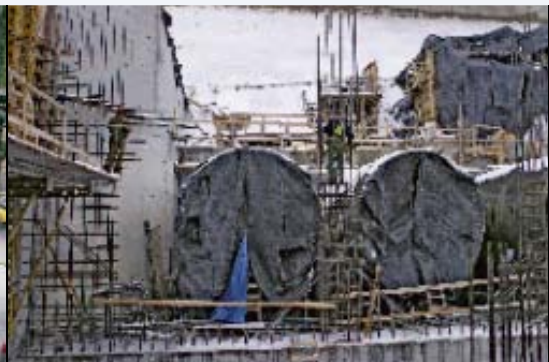
La centrale Mercier, sur le réseau en 2006.
