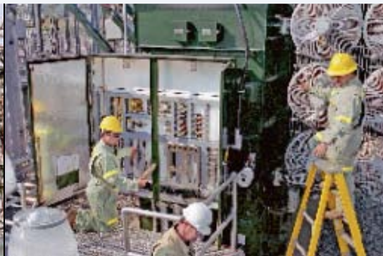
Au poste de L'Acadie, la capacité de transport a doublé.
