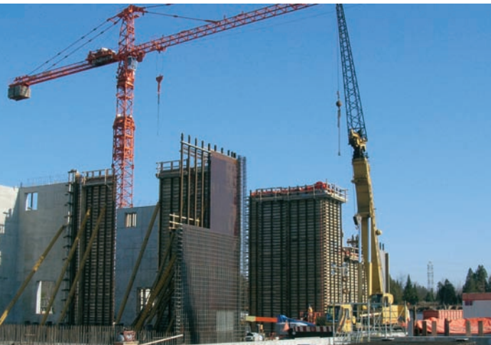
Érection des murs et de la structure de la partie des convertisseurs du poste de l'Outaouais.
