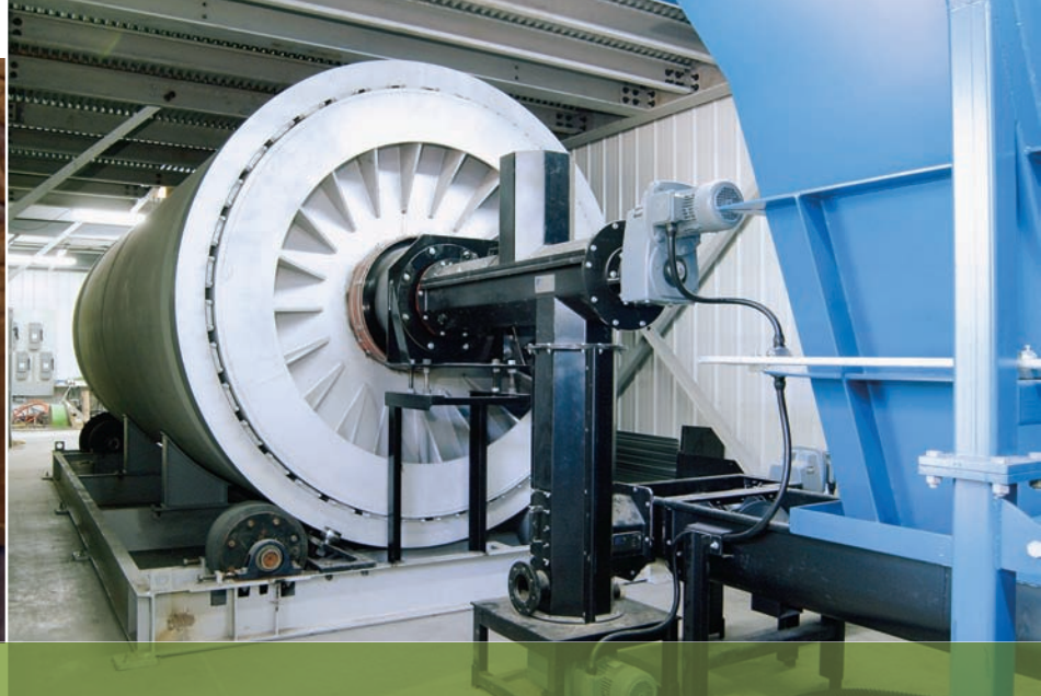
Développé par le Laboratoire des technologies de l'énergie, un four rotatif équipé d'une torche à plasma servant à assécher les boues biologiques a été installé à l'usine d'épuration de Valleyfield.
