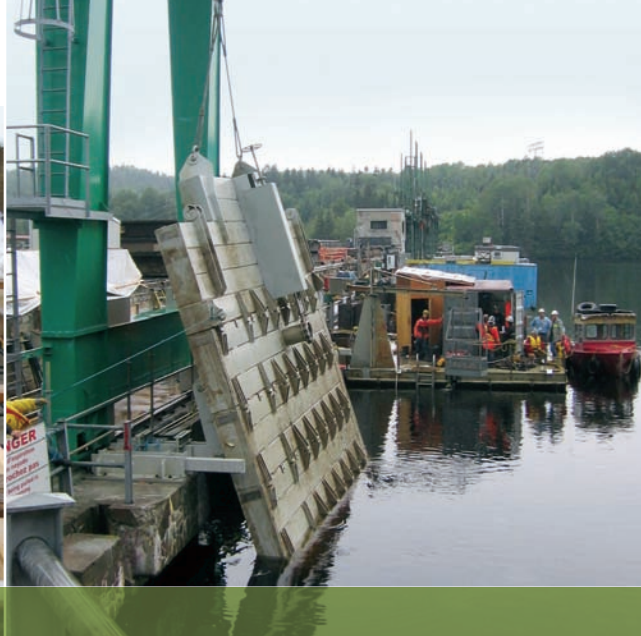
Sur le site de la centrale de La Tuque, mise en place d'un batardeau.
