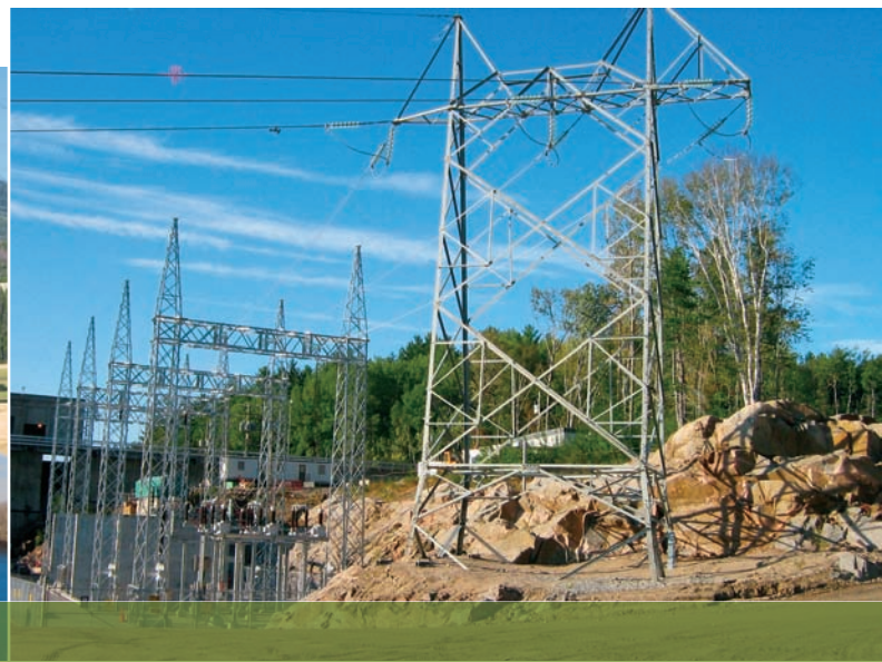
Un poste et une ligne à 69 kV relie au réseau la centrale Mercier.
