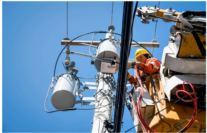
Une monteuse installe le système MILE (maintenance intelligente de lignes électriques) sur une ligne de distribution dans les Laurentides.
