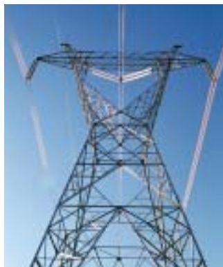
Pylône à 735 kV.
