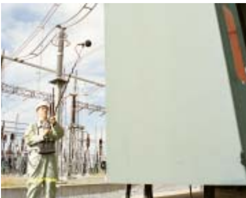
Prise de mesures de bruit des transformateurs.
