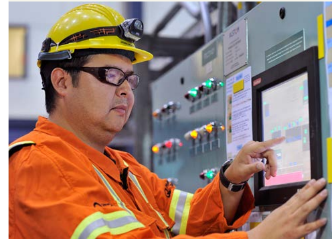
L'électricien d'appareillage Jasmin Mowatt devant le panneau de contrôle du système oléopneumatique d'un groupe de la centrale de la Sarcelle.
