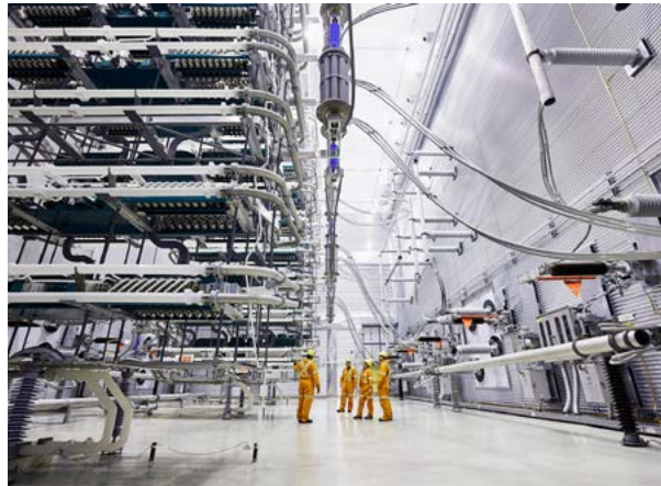
Salle des convertisseurs du poste de l'Outaouais, qui permet les échanges avec l'Ontario.
