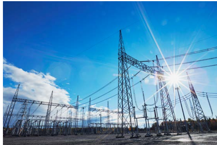
Poste de l'Outaouais à L'Ange-Gardien, partie intégrante d'une interconnexion avec l'Ontario.
