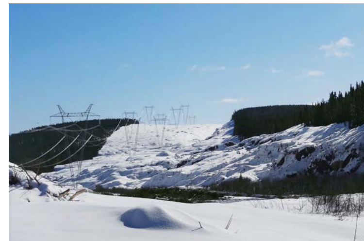
^^ Ligne à 315 kV reliant les postes de la Romaine-1 et de la Romaine-2, en chantier.
