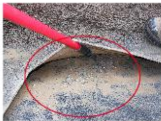
Présence de cailloux entre la GM et le géotextile. Risques de poinçonnements de la GM
