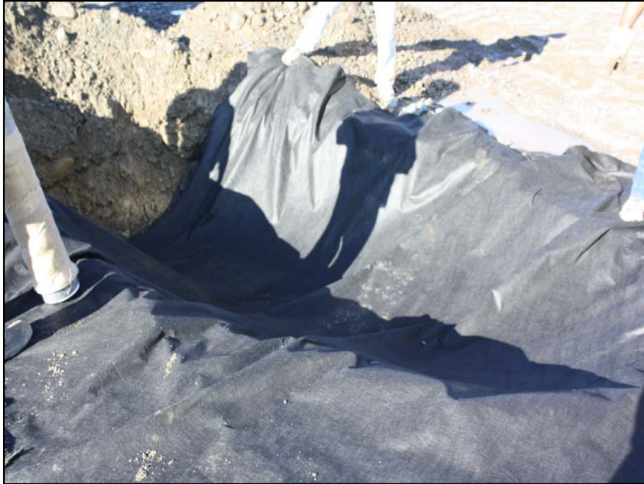
Photo 14.5 : Puits d'observation – géotextile installé
