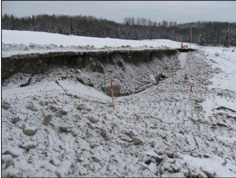
Photo 5.5 : Digue est – Glissement du talus amont
