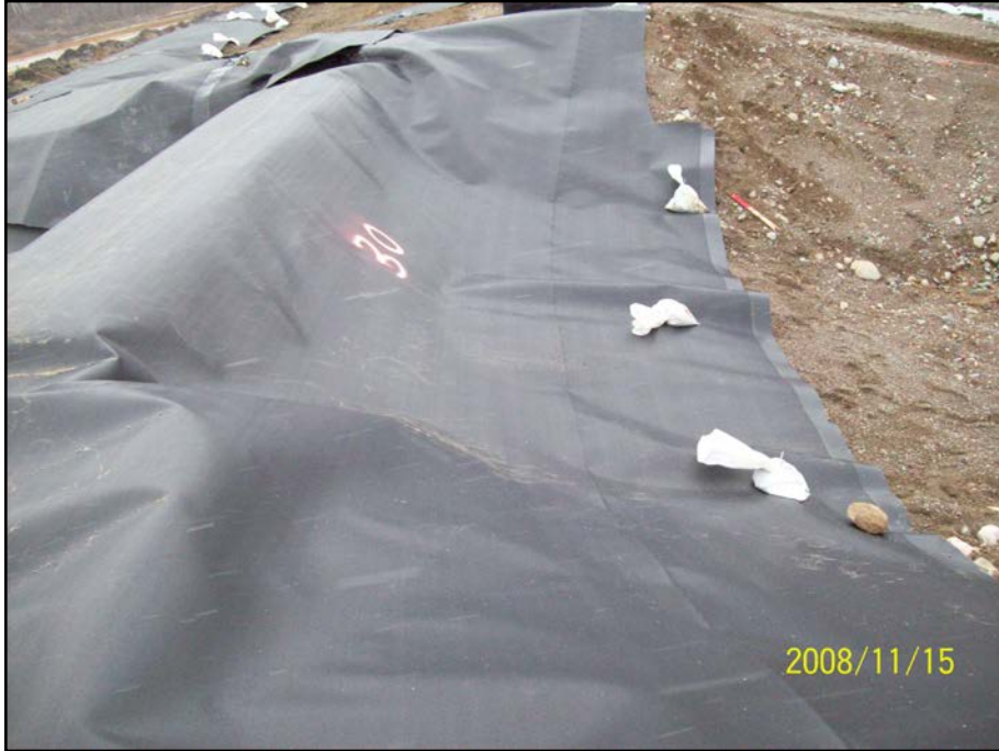
Photo 7.3 : Digue G – Géomembrane des déversoirs installée
