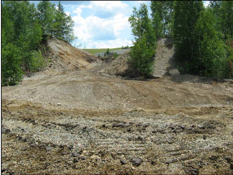
Photo 14.11 : Bassin digue C – brèche nord-ouest
