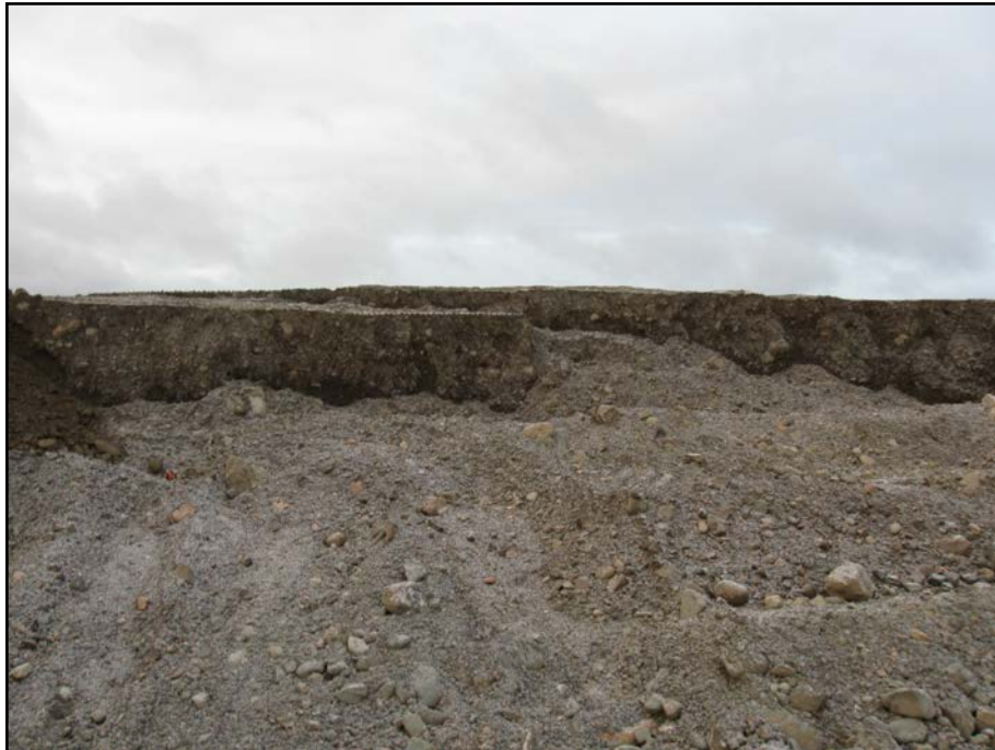
Photo 5.4 : Digue est – Glissement du talus aval
