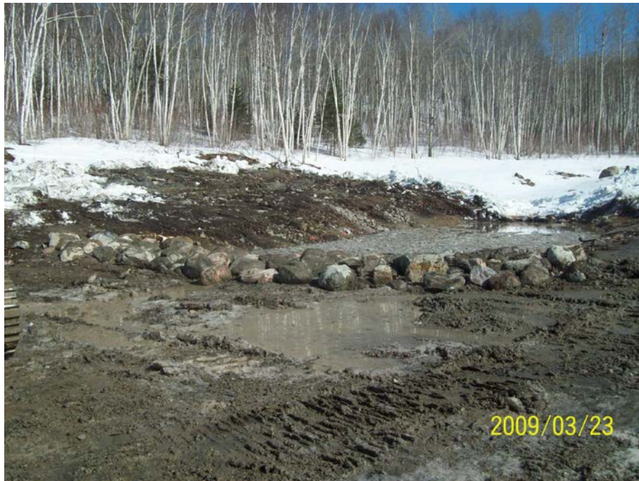
Photo 7.11 : Terrasse 1 – Bassin de dissipation d'énergie
