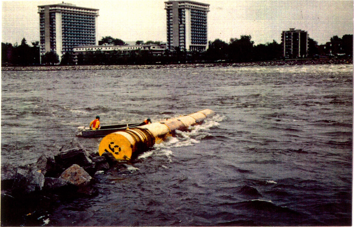
Photo 1-Structure flottante de la barrière de chaînes
