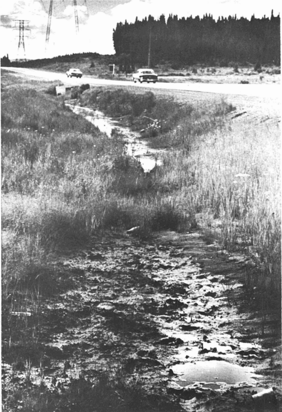
Figure 5. Fossé le long du boulevard Talbot dans le Parc des Laurentides.
