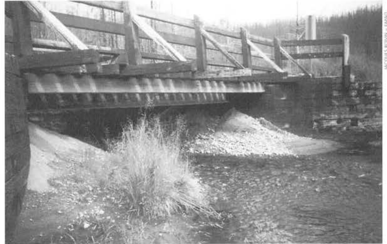
Amoncellement de sable et de gravier sous le tablier ouvert d'un pont. Outre cette perte d'habitat aquatique, le rétrécissement et la diminution de profondeur du cours d'eau limiteront progressivement la libre circulation du poisson.
