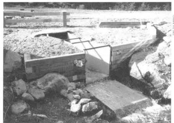
Appareil de mesure du débit à l'exutoire.
