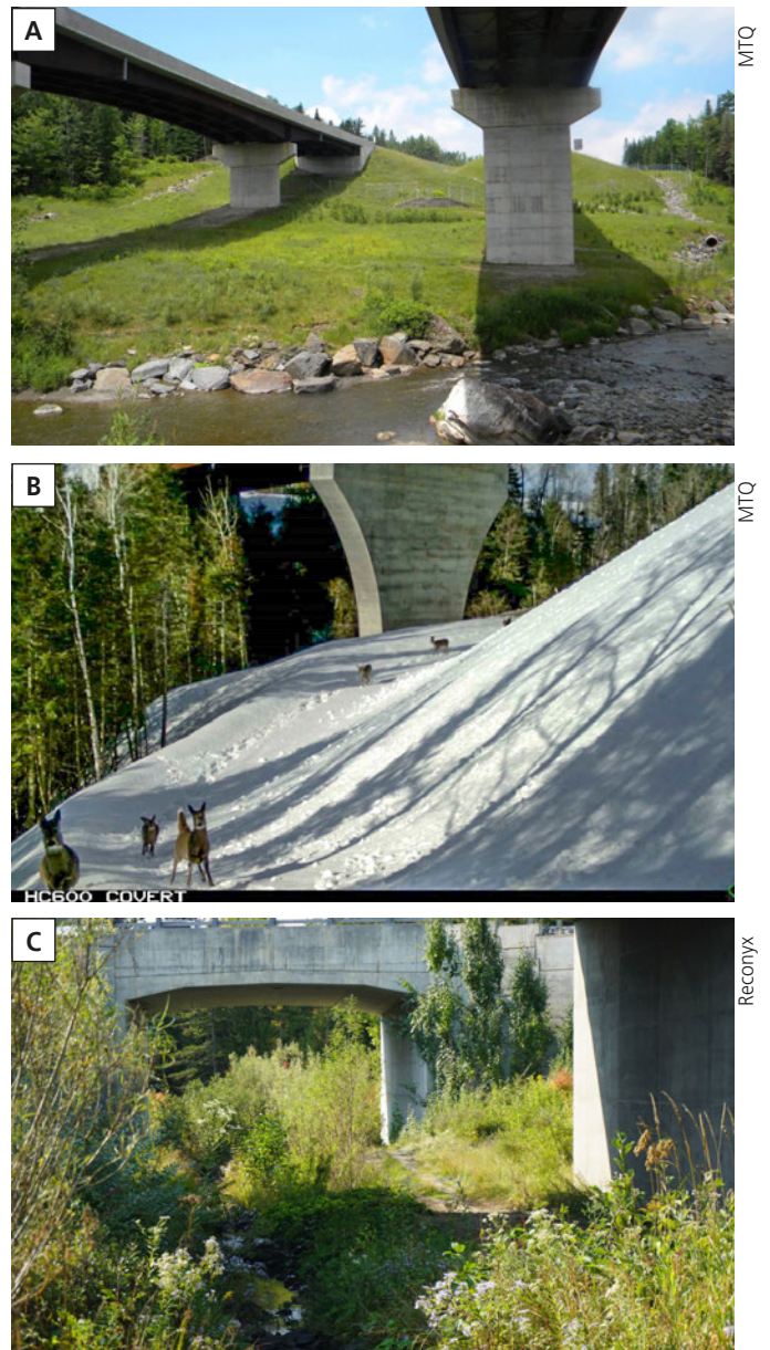
Figure 4. Photos du pont de la rivière des Plante (A), du pont de la rivière Famine (B) et du passage du ruisseau Doyon (C).
