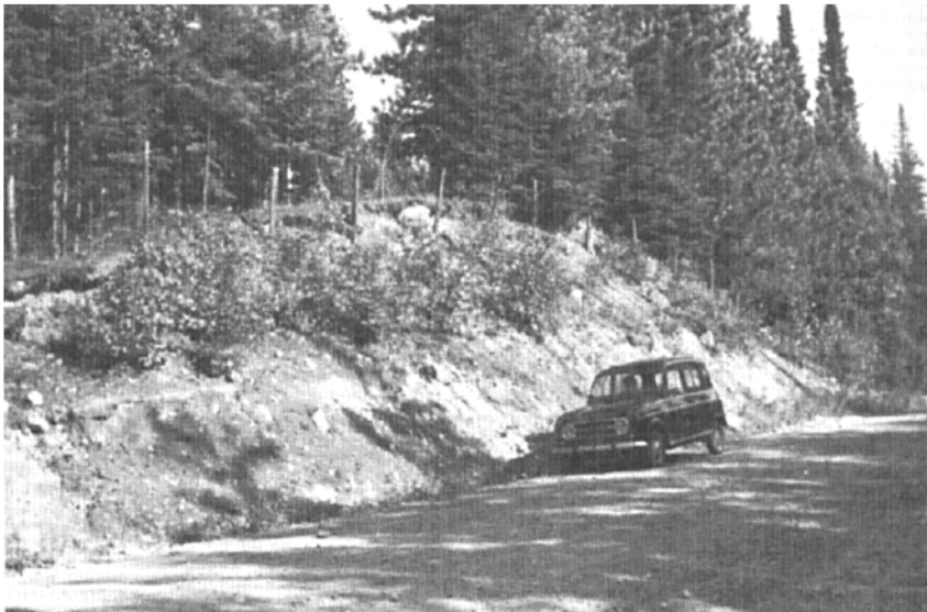
FIGURE 5 - Coupe transversale d'un bourrelet de la moraine terminale de Saint-Narcisse sur le chemin du rang de Saint-Edmond. A section through a ridge of the Saint-Narcisse terminal moraine, along Rang Saint-Edmond road.
