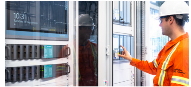
Tests menés au poste de Saint-Chrysostome dans le cadre de la mise en œuvre d'un projet témoin d'installation de nouvelles technologies numériques.
