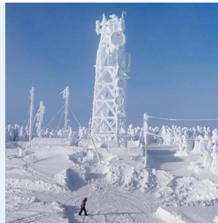
Site de transmission par ondes hertziennes.
