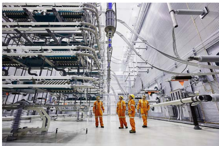
Le poste de l'Outaouais, principal élément de l'interconnexion de 1250 MW avec l'Ontario. Les exportations d'hydroélectricité ont pour effet d'éviter l'émission de quantités impressionnantes de GES.
