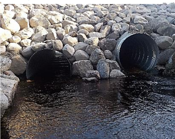
À la fin des travaux, les conduits sont davantage enfouis en aval. Ici, on peut observer la surélévation du conduit conventionnel et le bassin de dissipation d'énergie. Photo : MFFP
