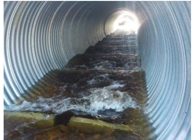
Écoulement de l'eau, de l'amont vers l'aval, dans le conduit muni de déversoirs. Photo : MFFP
