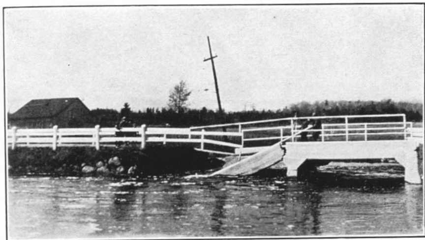
Pont renversé sur Ruisseau Rouge, route Sherbrooke-Montréal, 1 mille de Magog, 5 novembre 1927.
