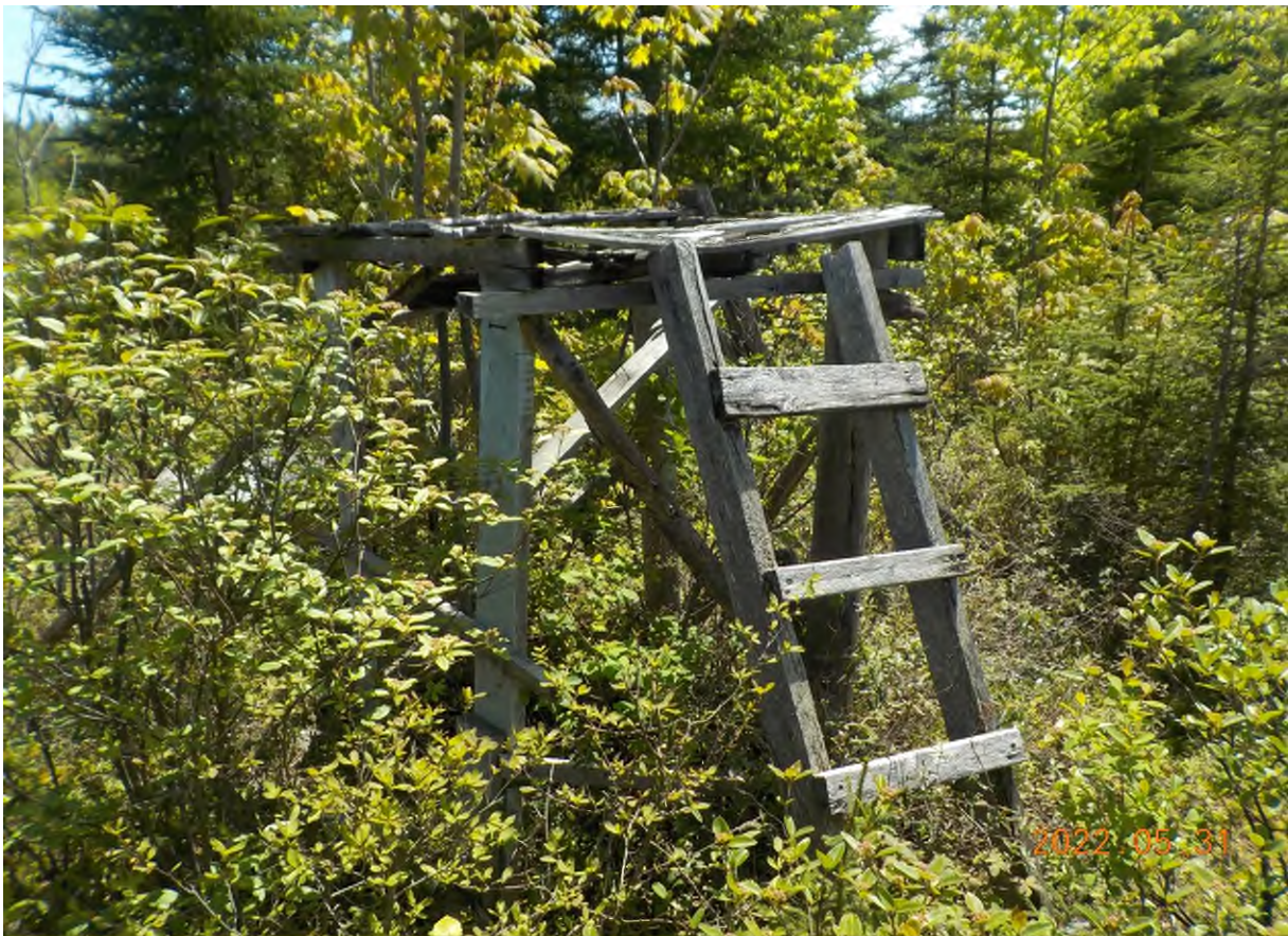
Figure 5 : Structure abandonnée au point supplémentaire B à démanteler.
