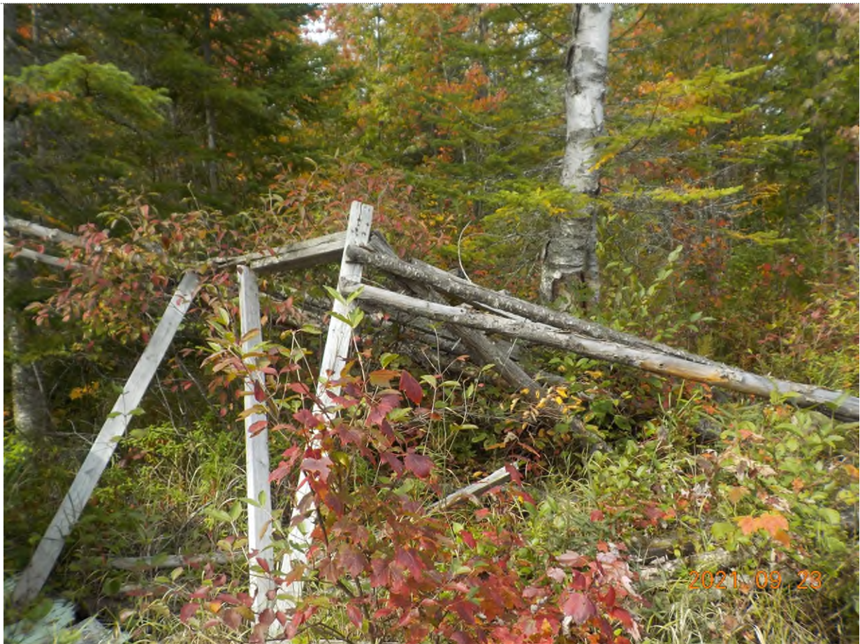
Figure 3: Base de la structure à ramasser
