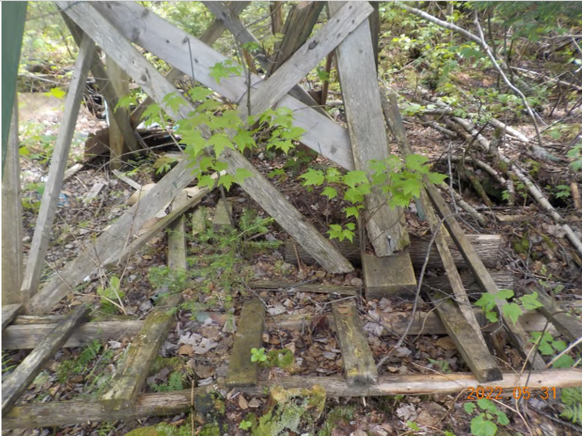
Figure 3 : Débris aux abords du site à ramasser.
