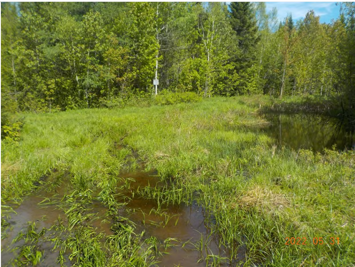
Figure 2 : État du chemin entre 350358 et 350351
