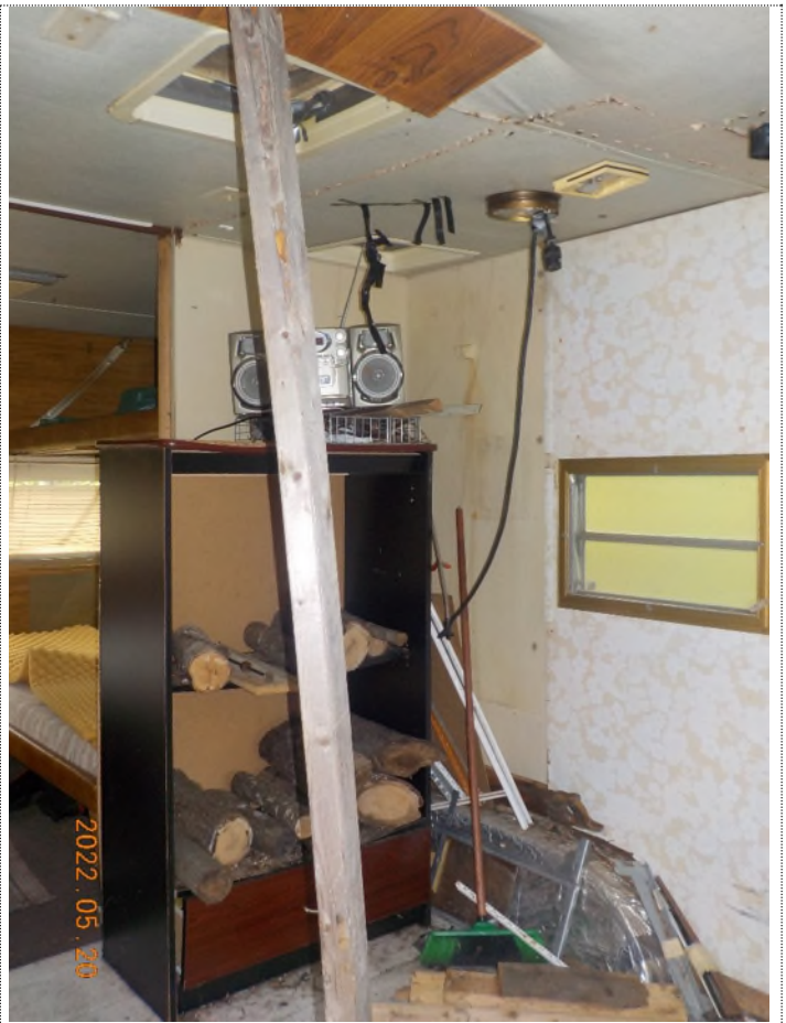
Figure 4: État du plafond et débris dans la roulotte Taurus
