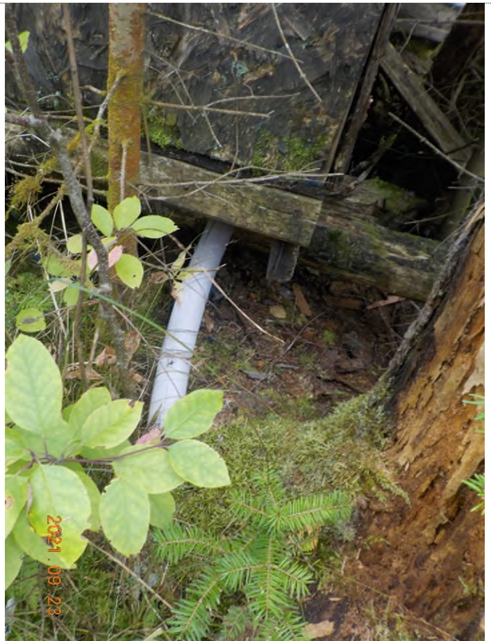
Figure 7: Tuyaux de PVC sous la cache
