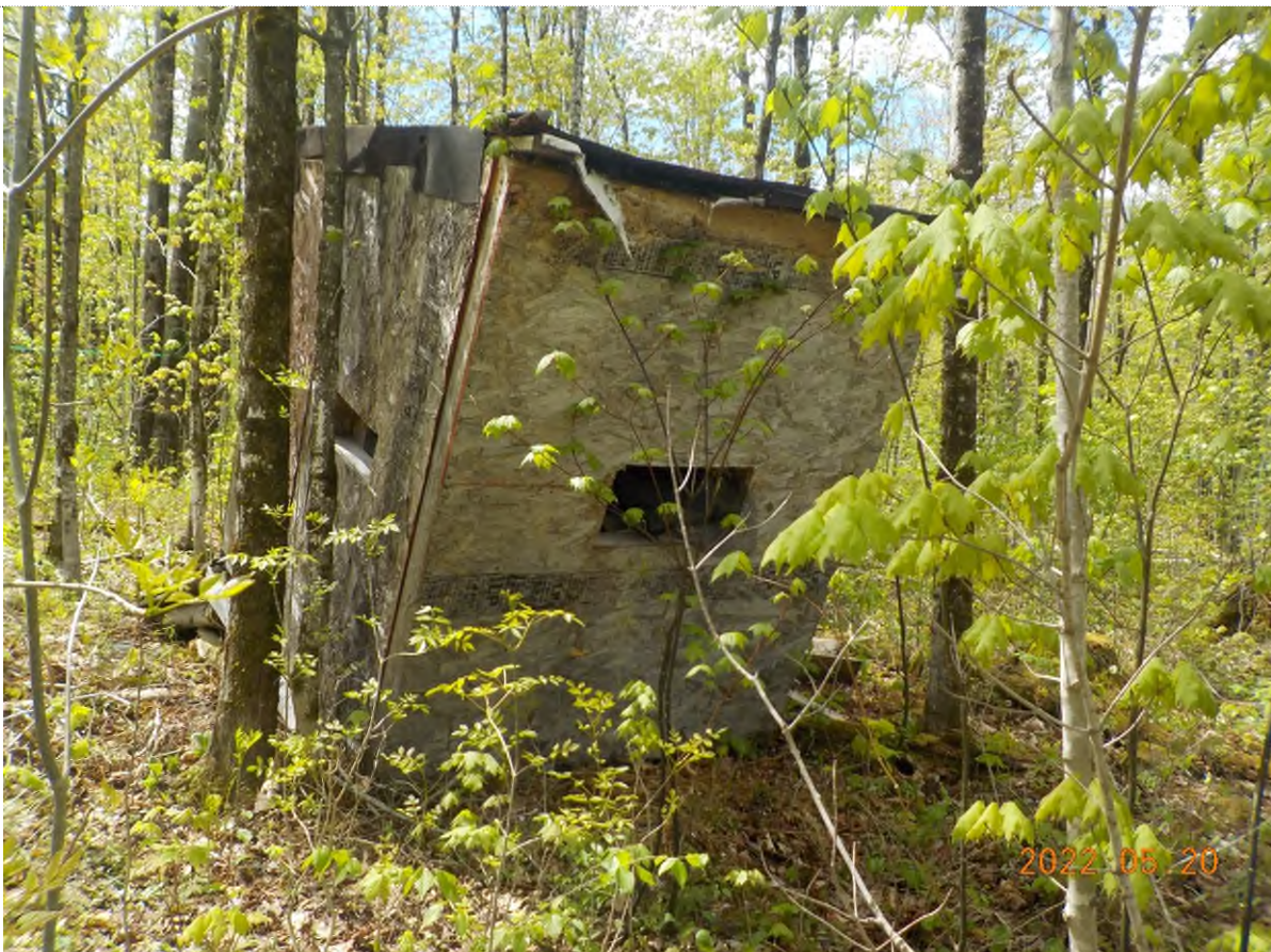
Figure 2: Structure abandonnée à démanteler
