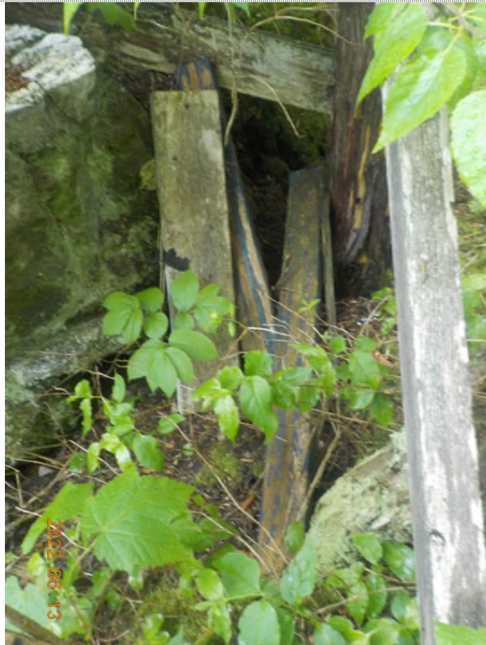
Figure 3: Débris à ramasser
