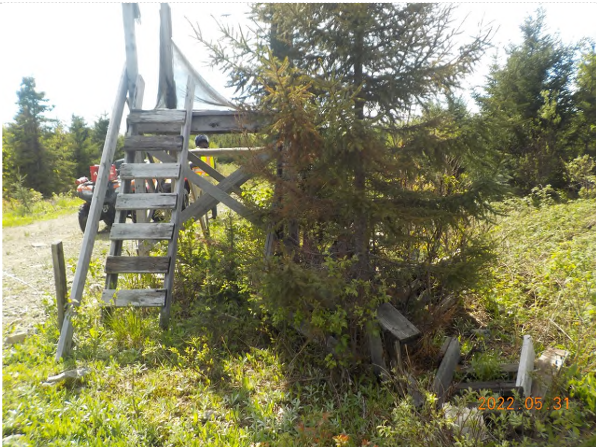
Figure 2: Autre vue de la tour de guet à démanteler et résidus d'ancienne structure à ramasser.
