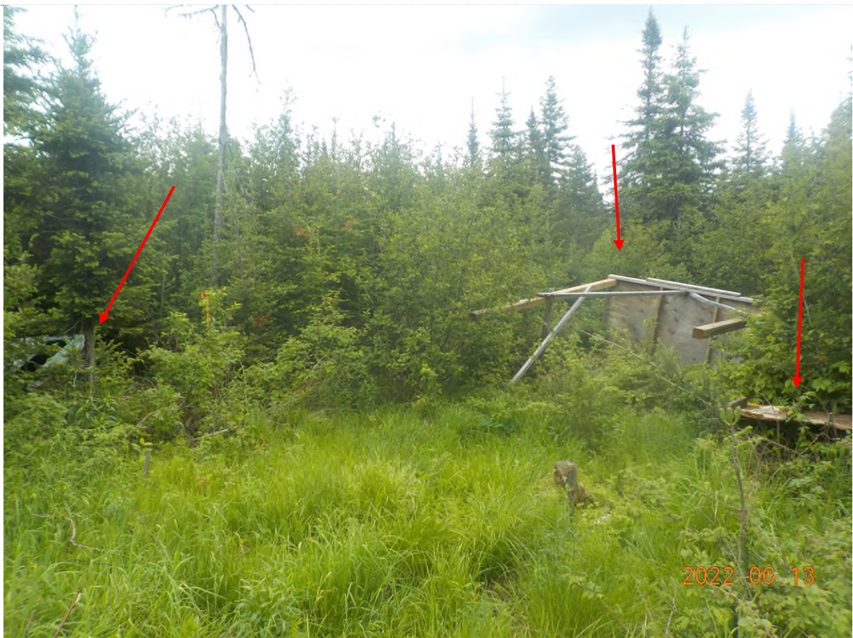
Figure 8: Emplacement de la plate-forme et débris
