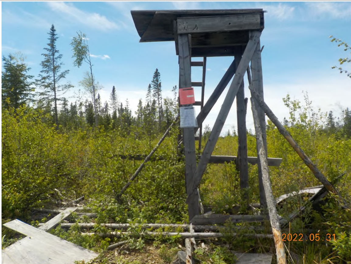
Figure 1: Structure abandonnée à démanteler.
