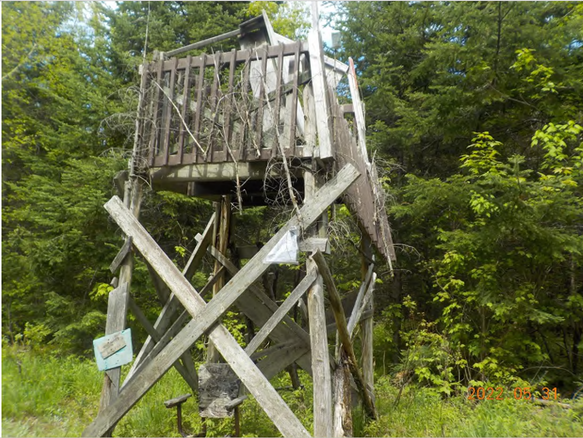
Figure 1 : Structure abandonnée à démanteler.
