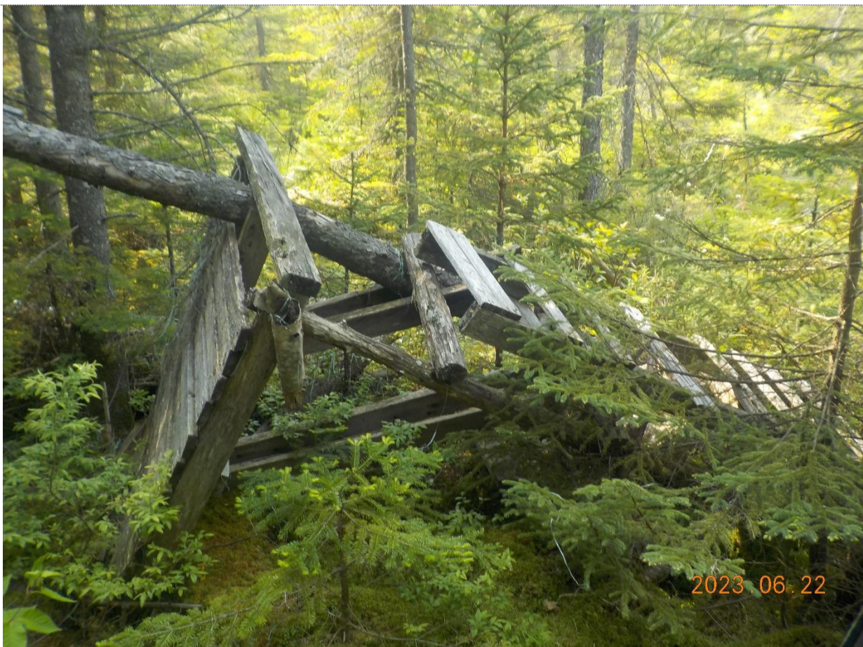
Figure 6: Autre vue de la structure abandonnée au point 350625-A à ramasser.
