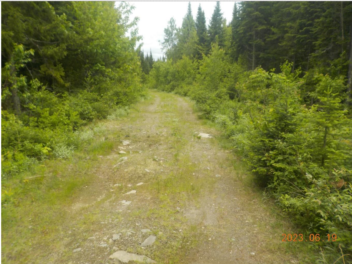
Figure 3: État du chemin forestier secondaire.
