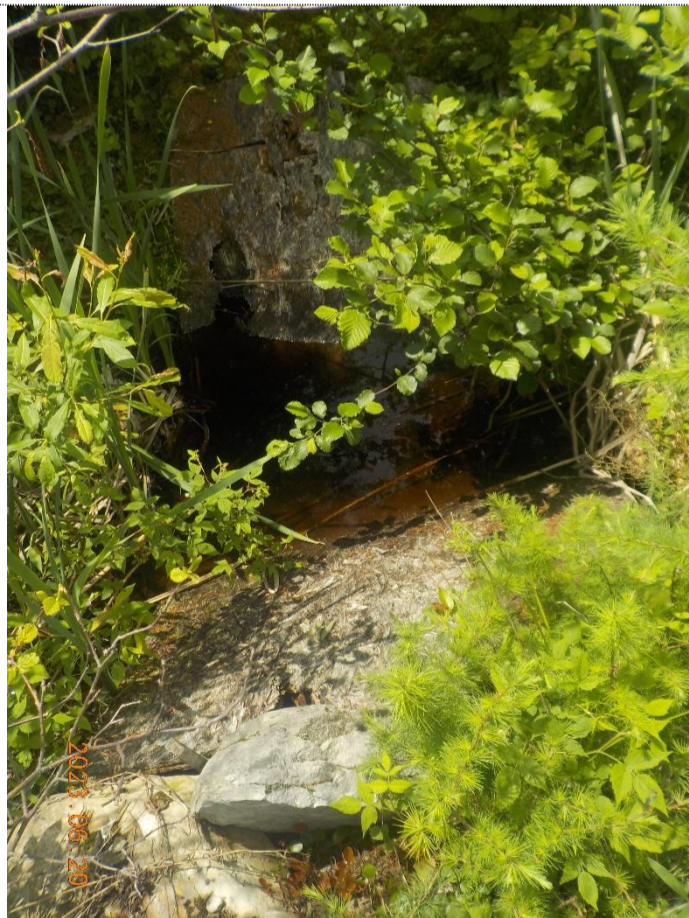
Figure 6: Débris au site 307732-A à ramasser
