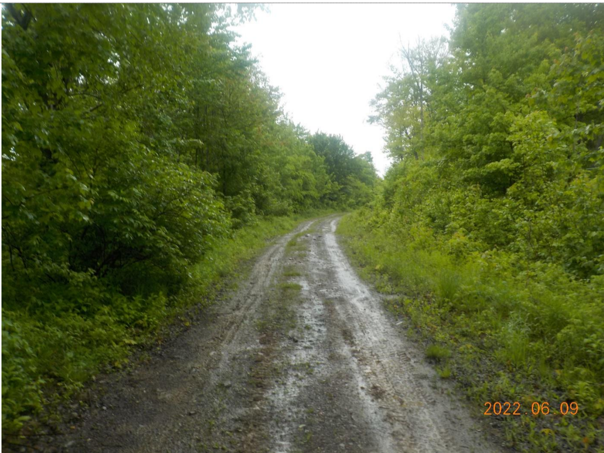
Figure 6 : État du chemin acéricole
