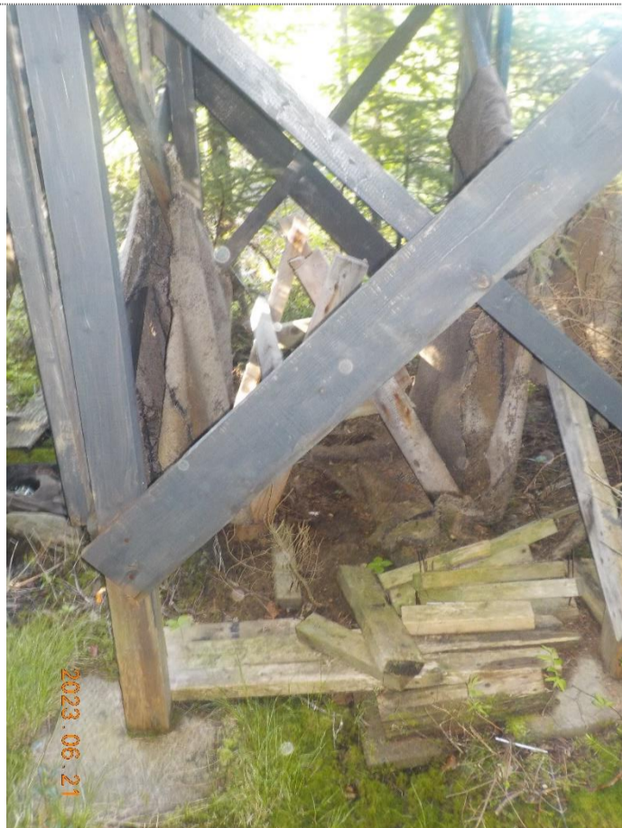
Figure 4: Débris à ramasser sous la tour de guet
