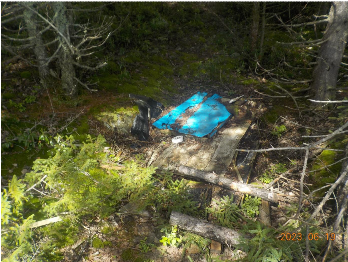
Figure 4: Structure écrasée à ramasser au site 350588-A.
