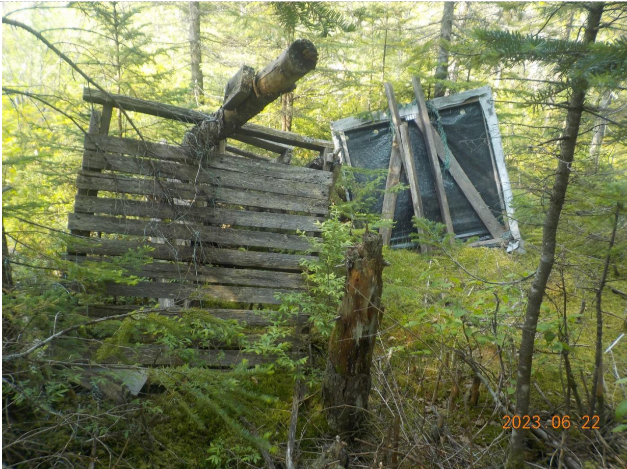
Figure 5: Structure abandonnée au point 350625-A à ramasser.
