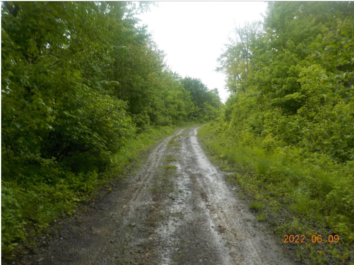
Figure 5 : État du chemin acéricole
