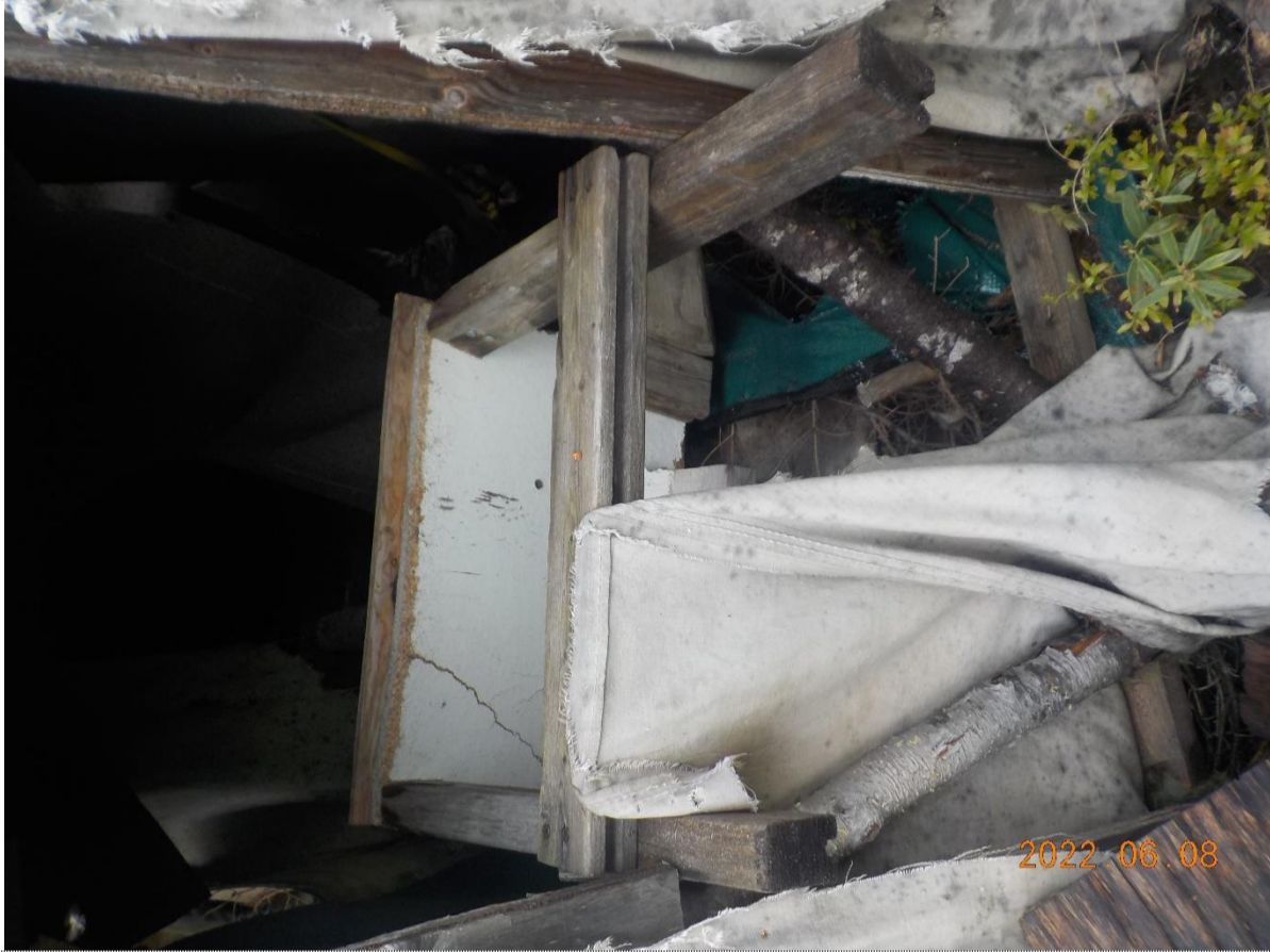
Figure 3 : Intérieur de la structure abandonnée.
