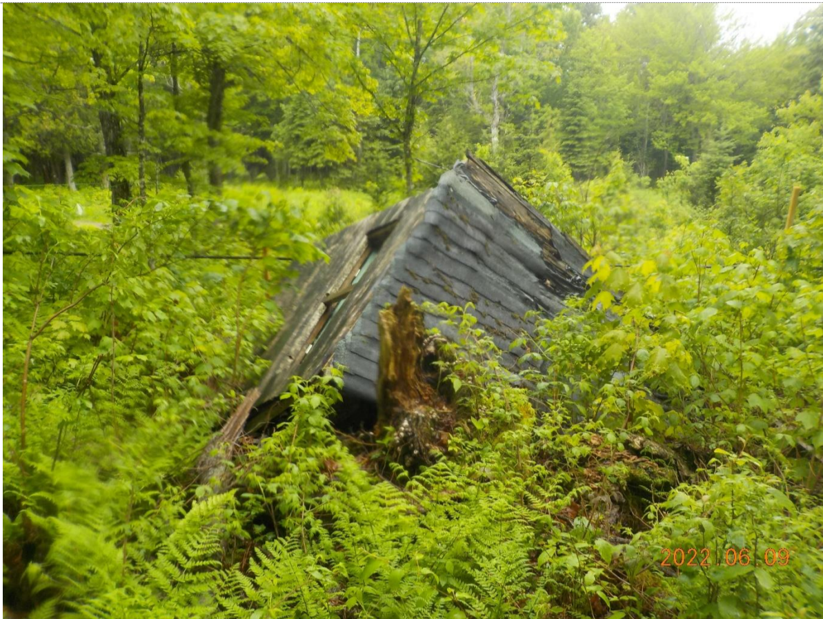
Figure 3 : Autre vue de la structure abandonnée à ramasser
