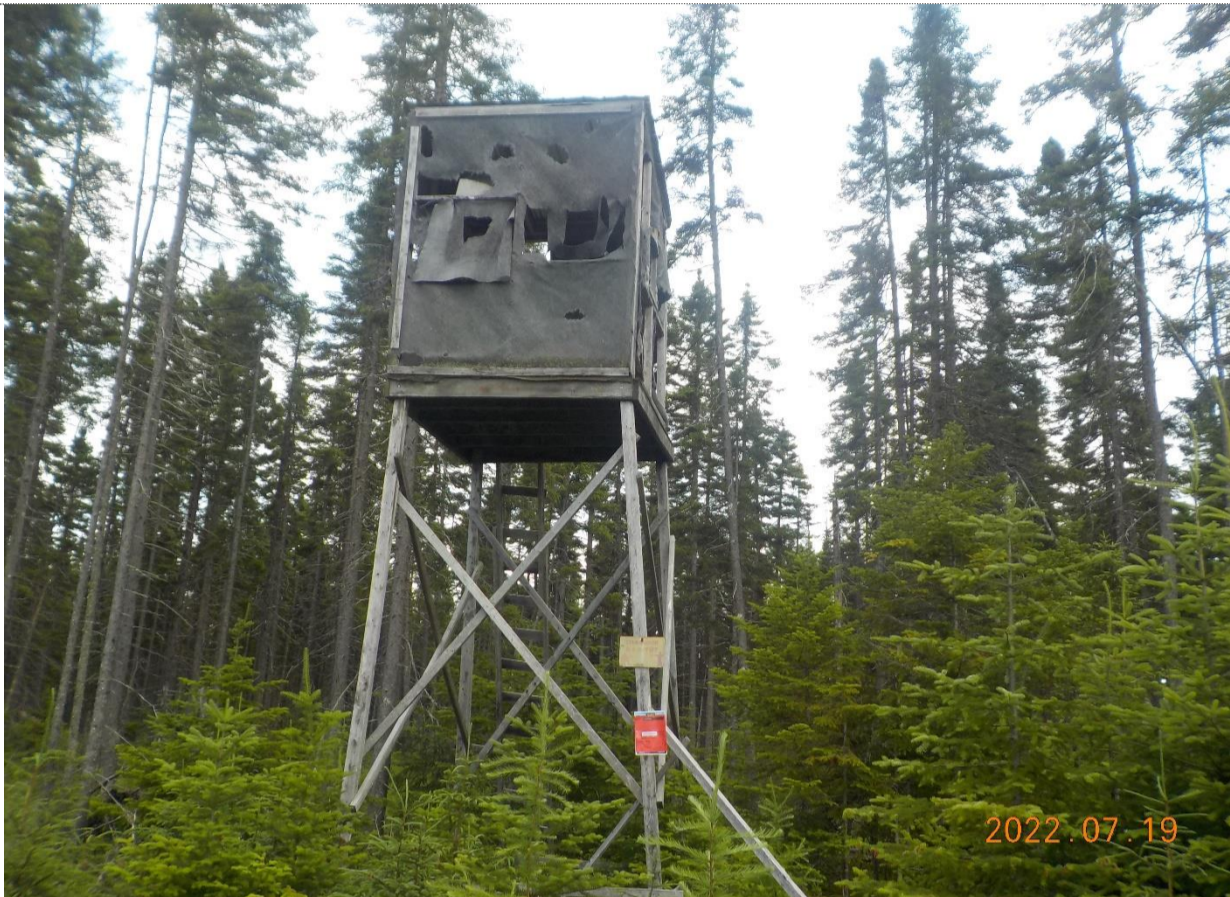
Figure 1: Vue de la structure avant qu'elle tombe au sol
