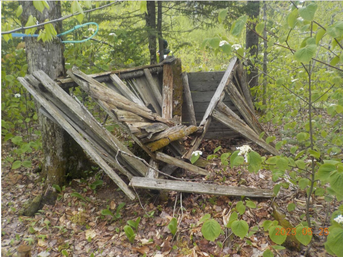
Figure 1: Structure à ramasser.
