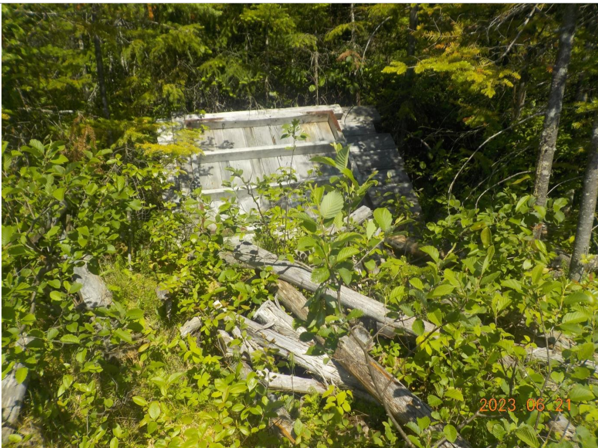
Figure 2 : Autre vue de la structure ainsi que les débris à ramasser
